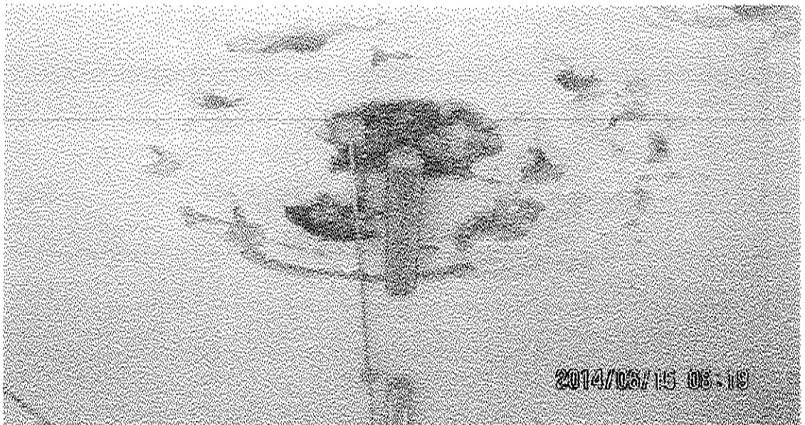
Soffitto con evidenti segni di infiltrazione d'acqua
